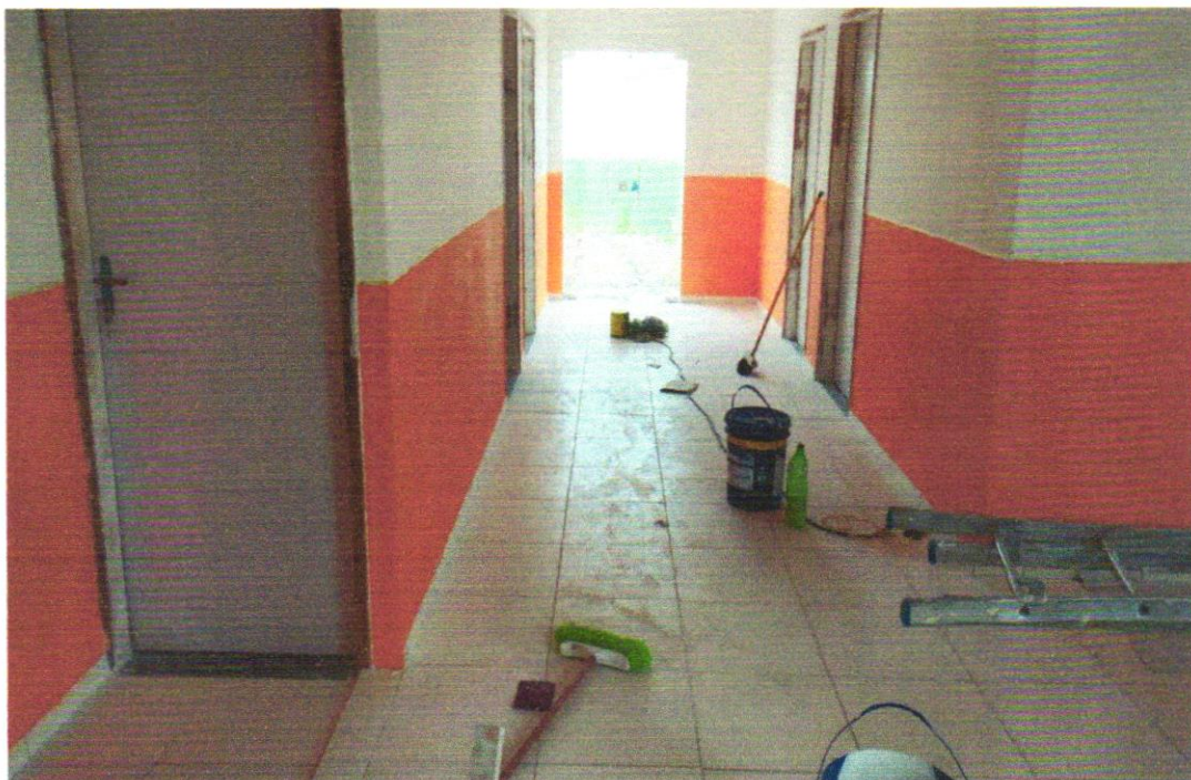
FOTO 9 - APLICAÇÃO MANUAL DE PINTURA COM TINTA LÁTEX ACRÍLICA EM PAREDES, DUAS DEMÃOS. AF_06/2014
