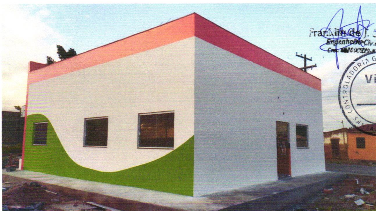
FOTO 04 - APLICAÇÃO MANUAL DE PINTURA COM TINTA LÁTEX ACRÍLICA EM PAREDES, DUAS DEMÃOS. AF_06/2014
